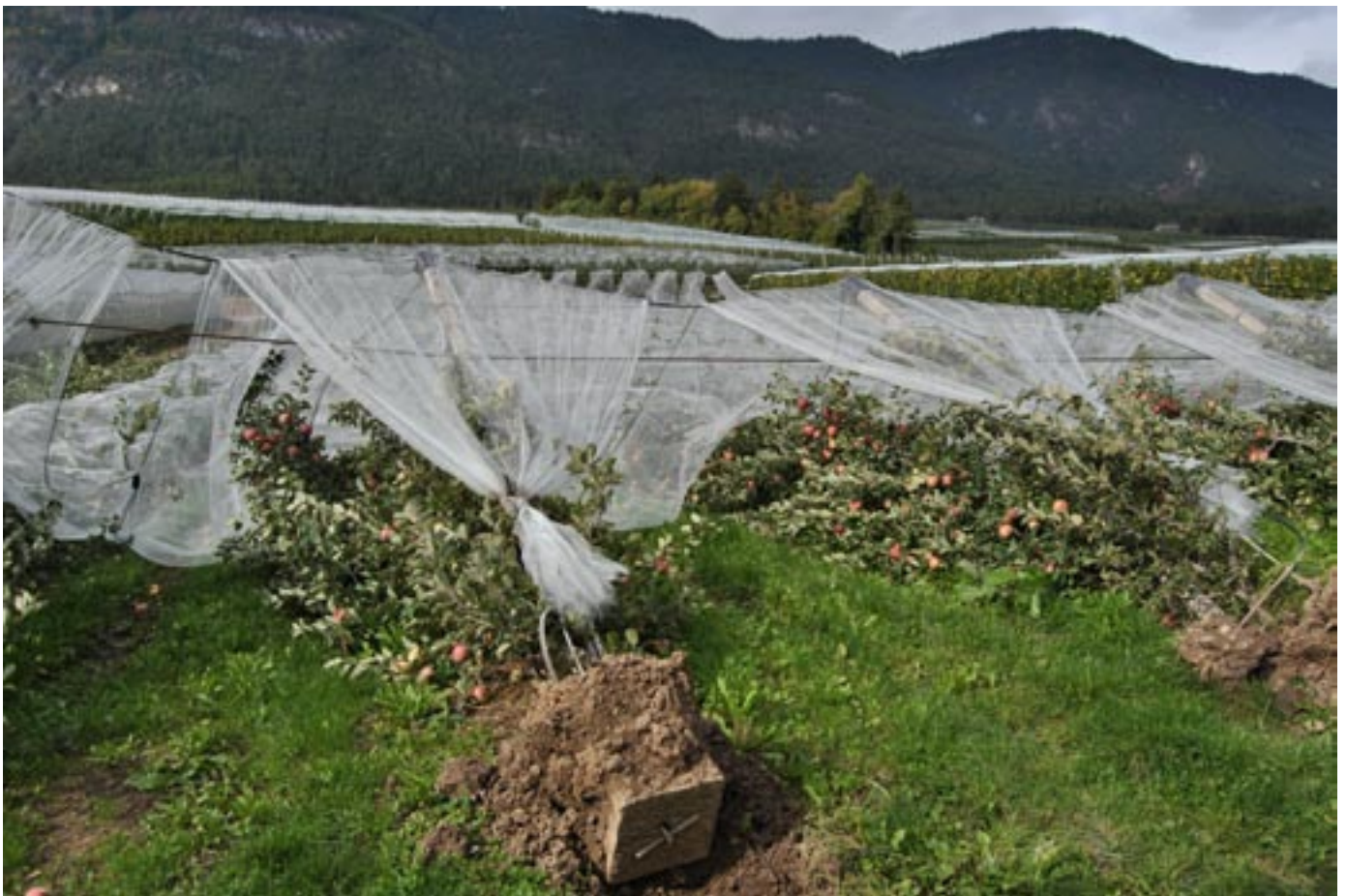
Un impianto antigrandine crollato a causa della neve.
